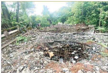
ကမမောင်း - ဗာပွန်လမ်းကြောင်းပေါ်ရှိ လမ်း/တံတားများအား ဖောက်ခွဲဖျက်ဆီးထားမှုကို တွေ့ရစဉ်။
